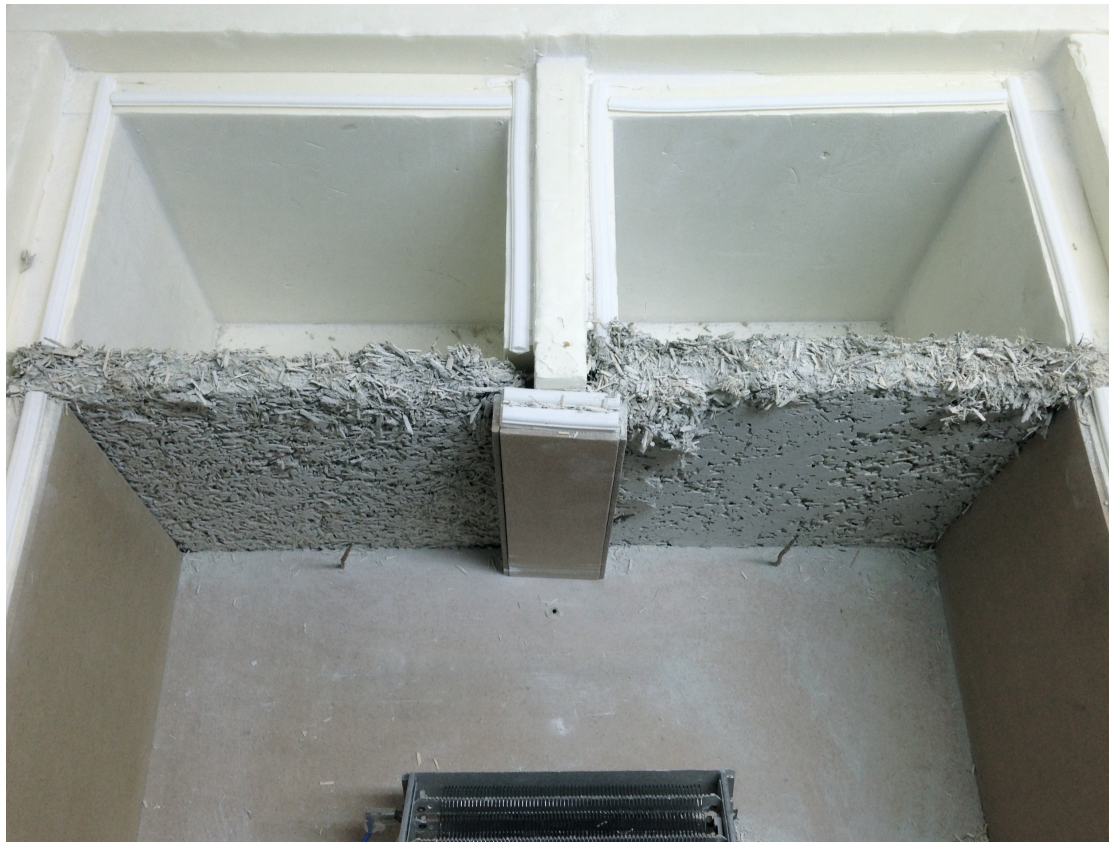
Photo des parois (sèche à gauche, humide à droite)
